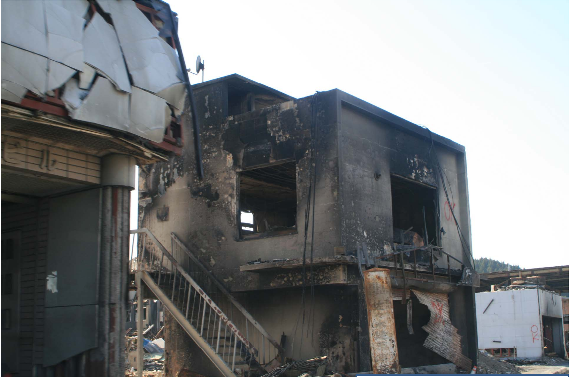
火災が発生した家屋 国道45号
