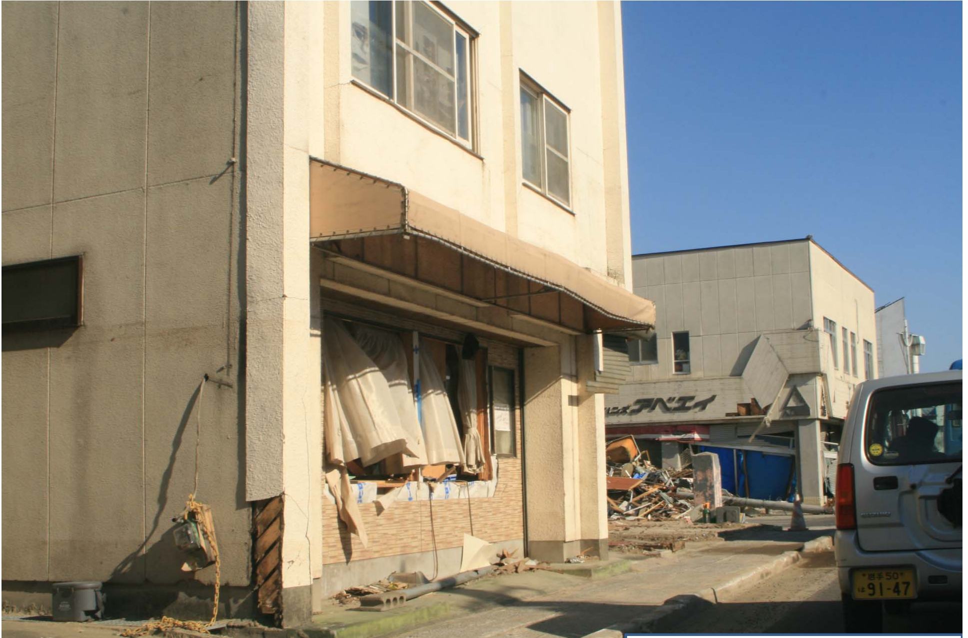
津波痕跡 国道45号
