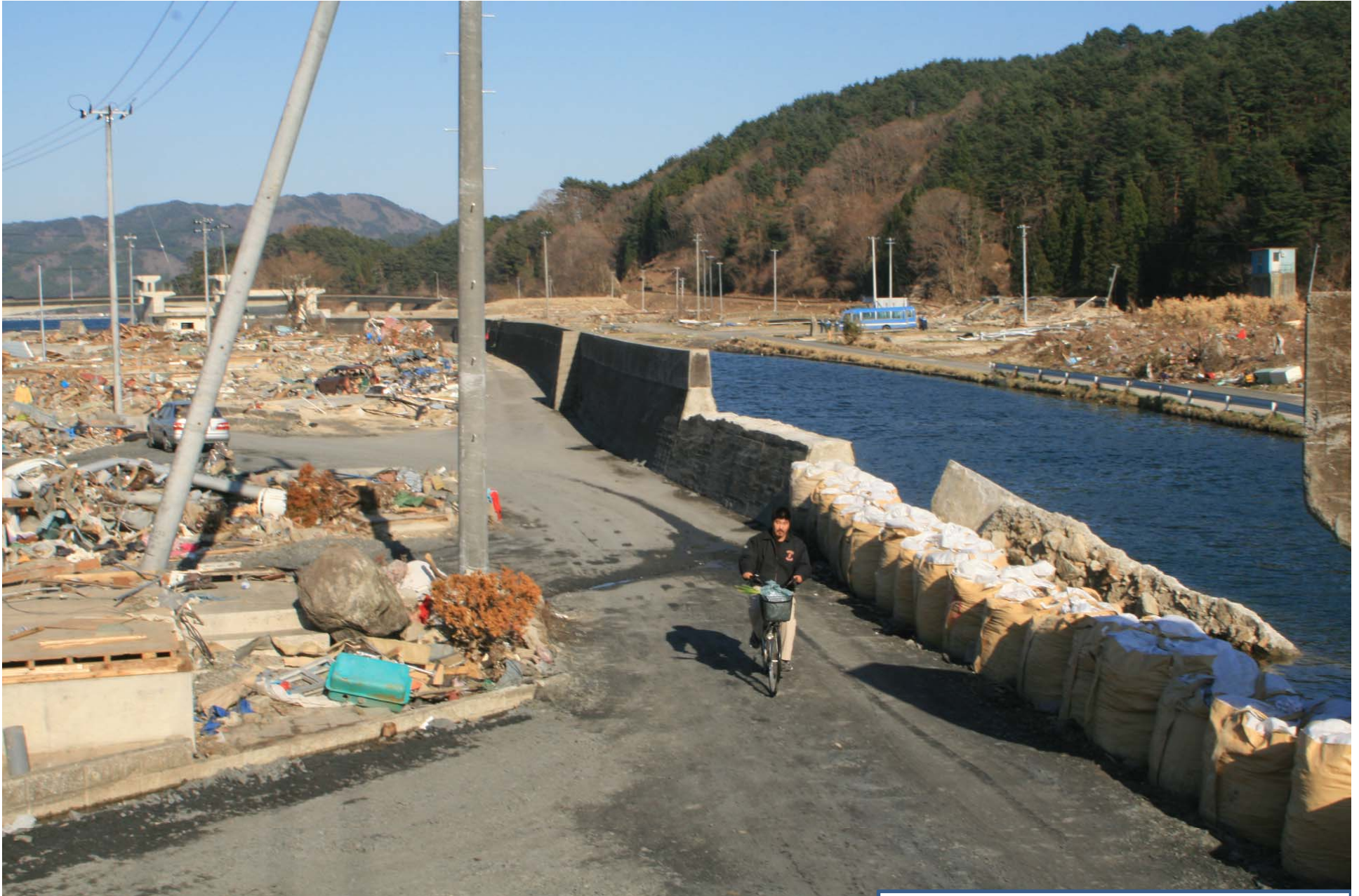
護岸の被災 織笠付近
