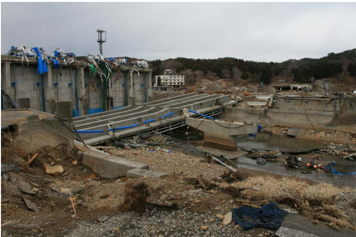
写真2 みなと橋被災状況（宮古市田老地区、右側が海）
