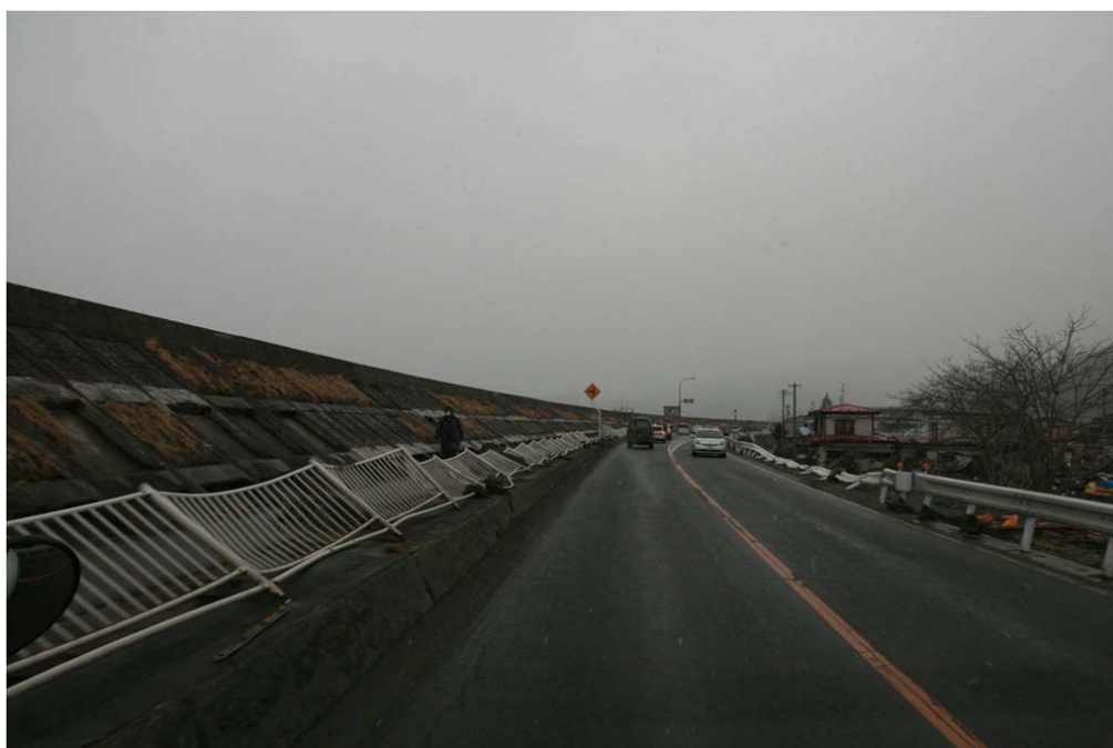
写真4 防護柵の被災（左側が海、国道45号宮古市高浜付近）
