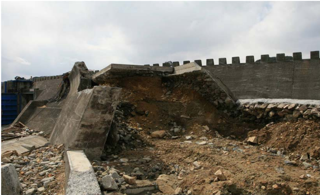
写真15 第2防潮堤の破断面（左側が海）
