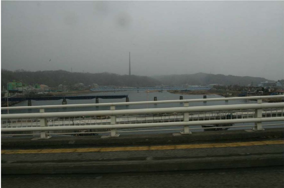
写真1 閉伊川に架かる JR 山田線鉄橋の被災
